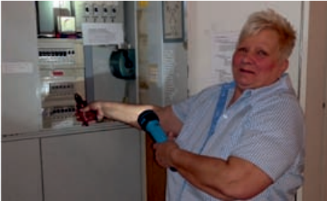
Unsere Küsterin Elke Walther bei der Fehlersuche am Sicherungskasten.
